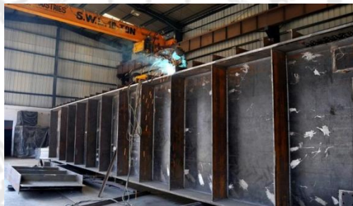
ภาพประกอบ 7 การเชื่อมประสานแผ่นเหล็กในการประกอบโครงสร้างเหล็ก
