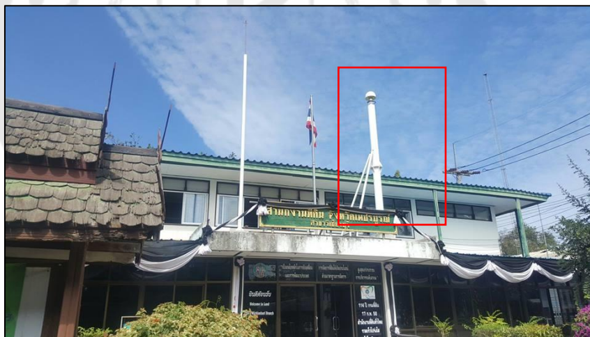
ภาพประกอบ 12 สถานีรับสัญญาณดาวเทียมถาวร สำนักงานกรมที่ดิน จังหวัดเพชรบูรณ์ (ติดตั้งบนอาคาร)
