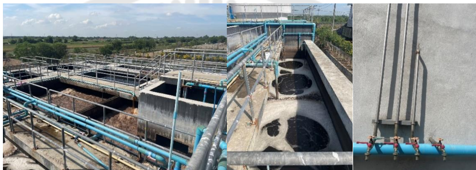
ภาพประกอบ 11 ระบบบำบัดน้ำชะขยะมูลฝอยแบบตะกอนเร่ง บริเวณสถานที่กำจัดขยะแบบเทกองกลางแจ้ง จังหวัดปทุมธานี จุดเก็บตัวอย่างน้ำ กากตะกอน และดิน
