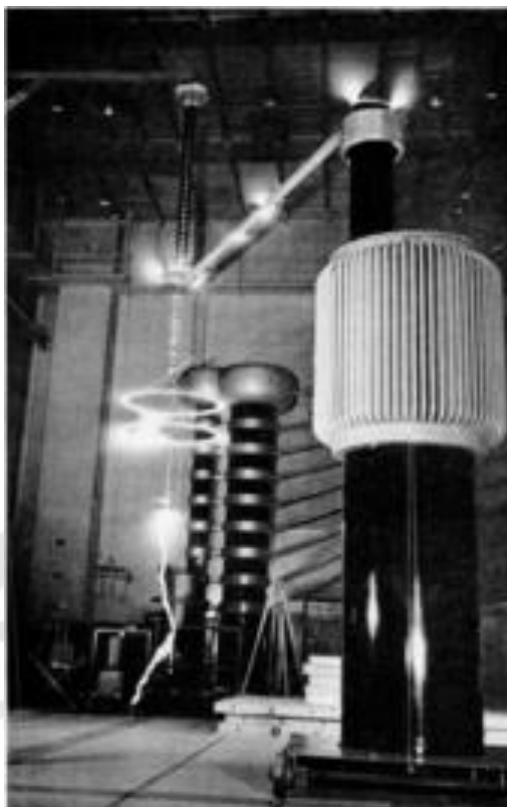
ภาพประกอบ 7 การปล่อยโคโรนาขนาดใหญ่ (สีขาว) รอบตัวนำไฟฟ้าที่ได้รับพลังงานจากหม้อแปลงไฟฟ้า 1.05 ล้านโวลต์ในห้องปฏิบัติการ US NIST ในปี 1941
