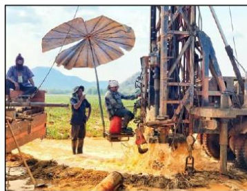
ภาพที่ 8 การเจาะน้ำบาดาลในฤดูแล้ง ที่มา https://www.matichon.co.th/news-monitor/news_2151164/
