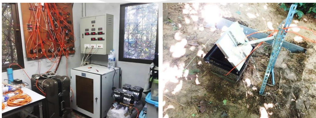
ภาพประกอบ 19 การติดตั้งระบบเครื่องวิเคราะห์ก๊าซคาร์บอนไดออกไซด์ รุ่น Licor-820
