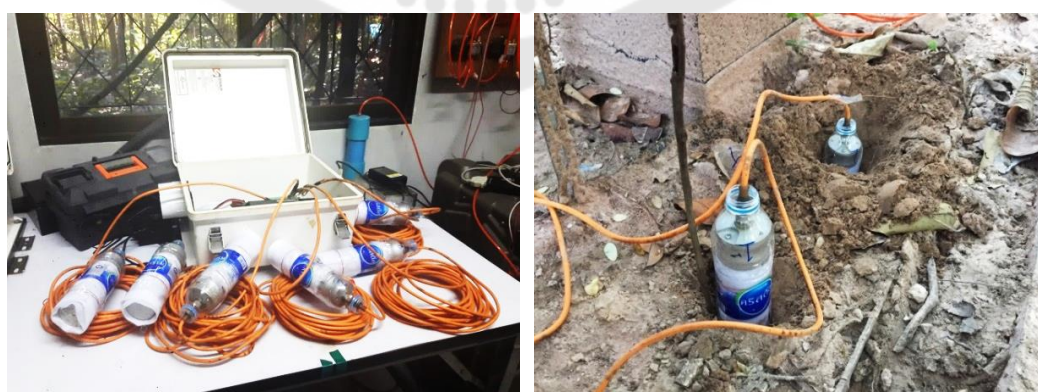
ภาพประกอบ 16 การติดตั้งระบบ carbon dioxide probe รุ่น GMP343
